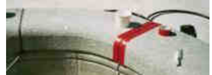
Praktische Ausführung der gewählten Lösung. Nach der Härtung des Materials, werden die Klebestreifen entfernt, und die Fugen mit sauberen Kanten sind fertig.
